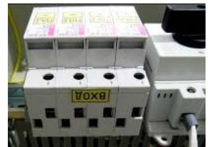
Подключение проводов СП «-»
