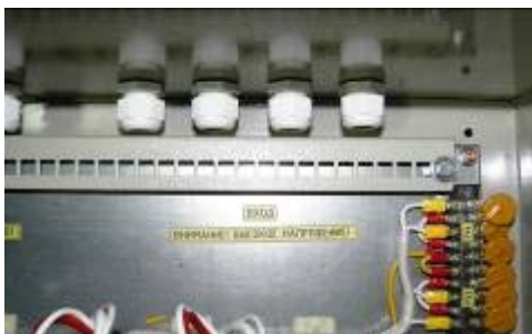
Зона ввода проводов от СП «-»
