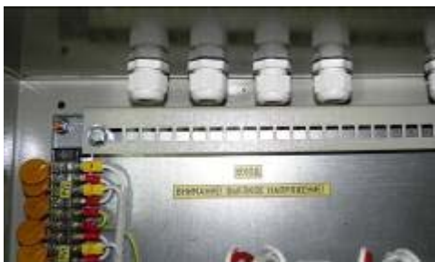
Зона ввода проводов от СП «+»
