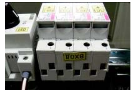
Подключение проводов СП «+»
