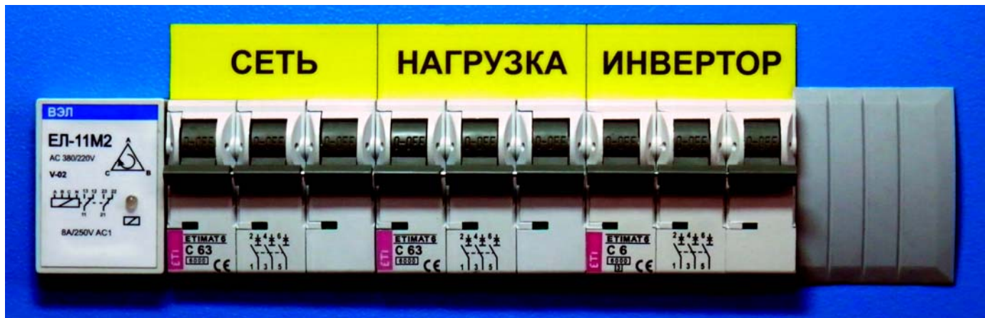
Рис. 4 Расположение автоматических выключателей на панели управления
