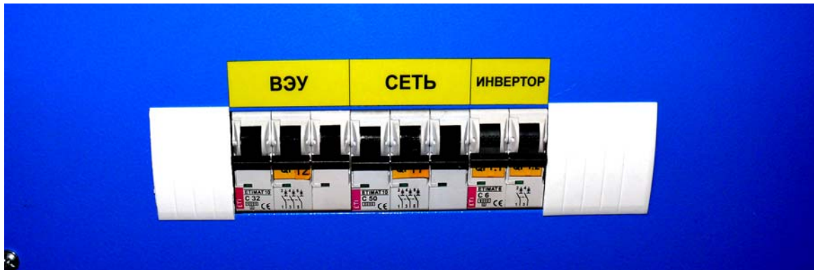
Рис. 4 Расположение автоматических выключателей на панели управления
